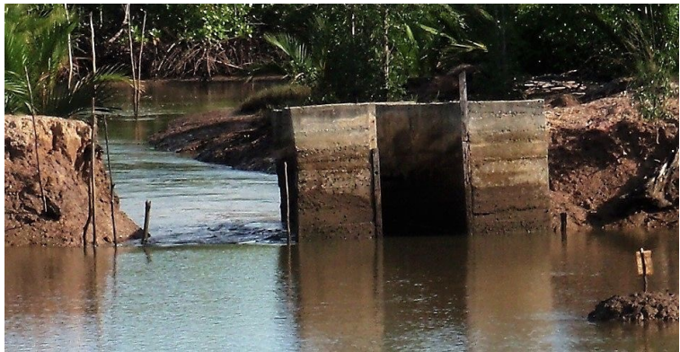
Figura 8: La hidrología es esencial para el éxito de la restauración. El ritmo de drenaje debe ser el mismo en el sitio de restauración como en el manglar natural fuera del estanque. Si el canal tiene una obstrucción en algún punto (aquí, la entrada a un antiguo estanque de camarón), pueden ensanchar excavando (como se hizo aquí al lado de la antigua compuerta) hasta que los ritmos de drenaje se igualen.
